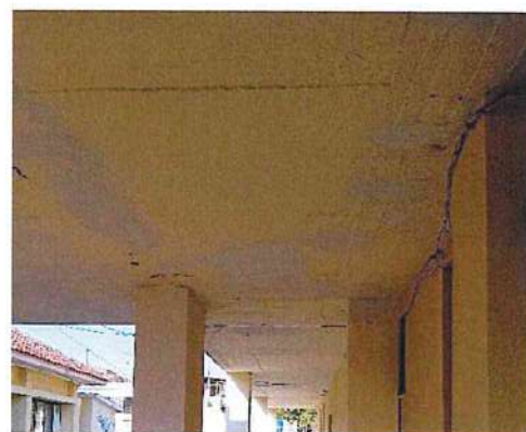
Εικόνα 9: Φθορές στην κρηπίδα του κτιρίου 2
