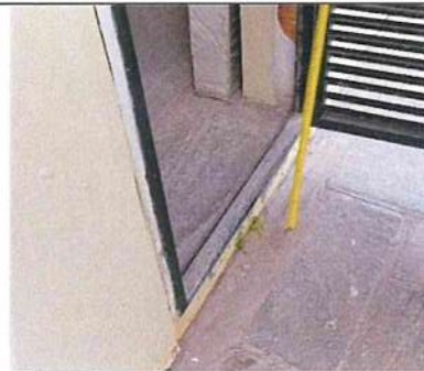
Εικόνα 11: Υψομετρική διαφορά 9εκ στην είσοδο του κτιρίου
