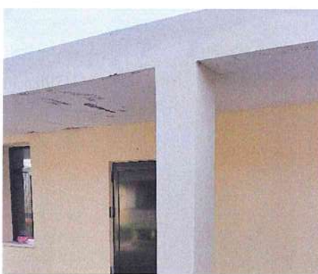
Εικόνα 8: Φθορές στην κρηπίδα του κτιρίου 2
